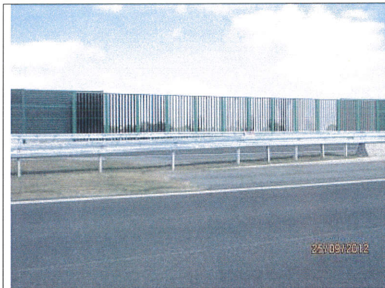
Km 220+200 – ekrany nad obiektem E6 zabezpieczające kolizji z ptakami
