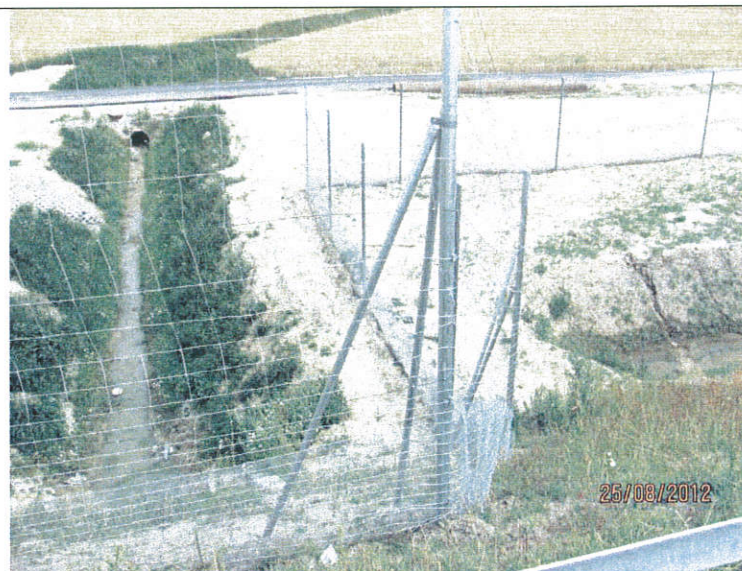
Km 234+600 –PZ4 - montaż ogrodzenia i siatki dogęszczającej w rejonie szlaków migracji płazów
