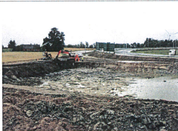
Fot. 2. Prace ziemne związane z budową zbiornika retencyjnego ZR 03 w rejonie węzła Kowal.
