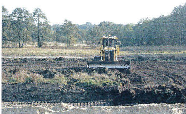
Fot. 1. Niwelacja terenu po lewej stronie pasa drogowego, km 240+500, widok od strony zachodniej.
